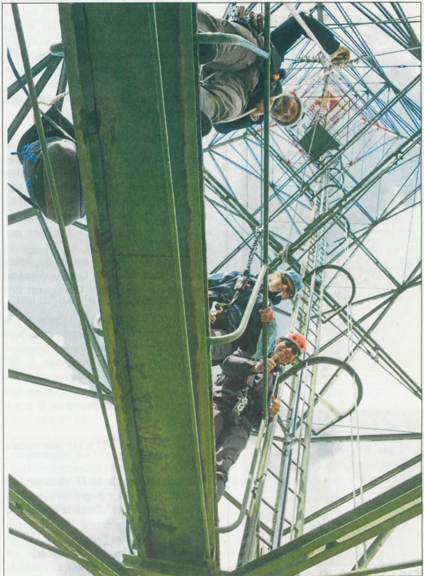
Au centre, les échelles à gravir pour atteindre le sommet de l'antenne.
